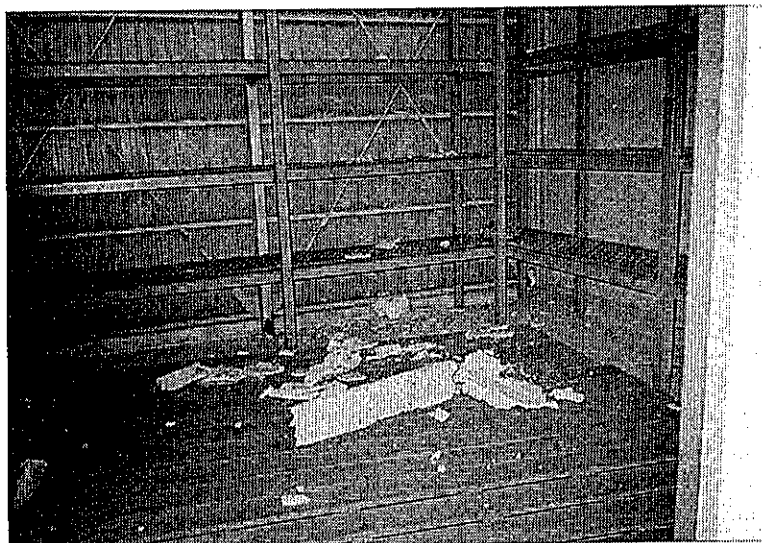
写真1 自然に落下した 天井の吹付け材
